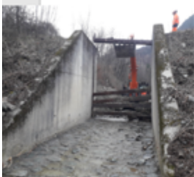
Reprise de la grille de fermeture de la plage de dépôt
